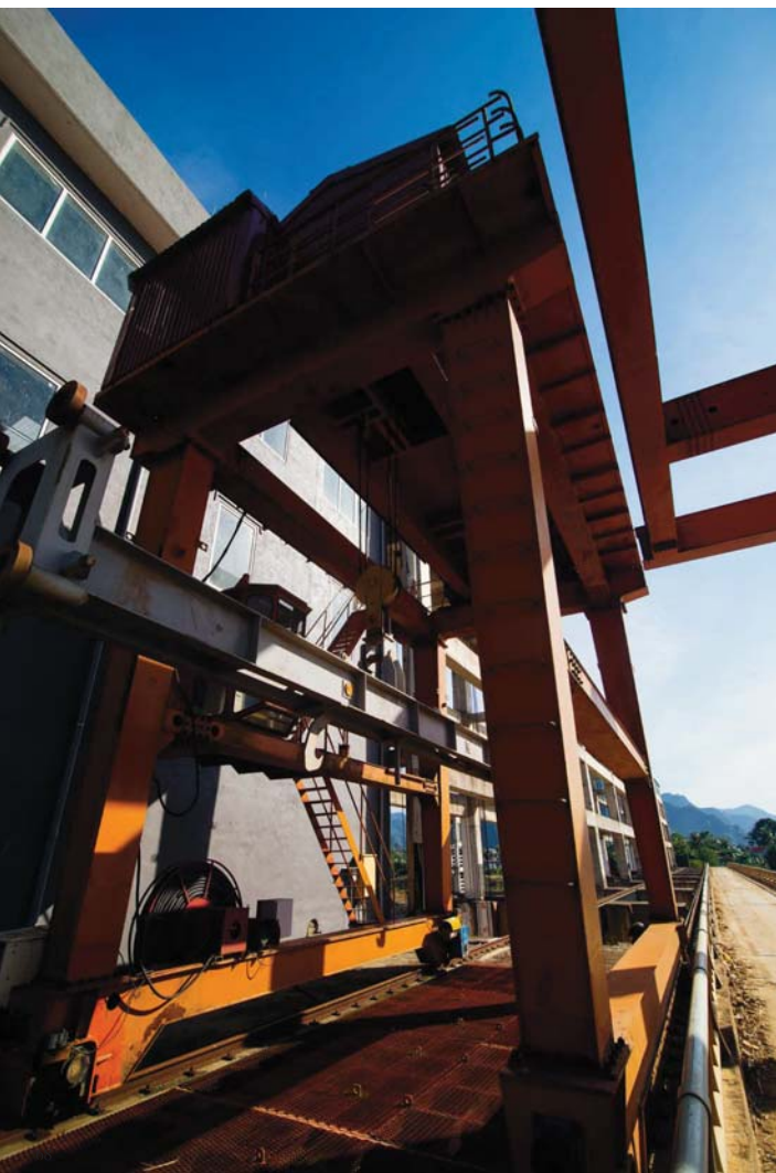
Cửa lấy nước của Nhà máy Thủy điện Cẩm Thủy I
